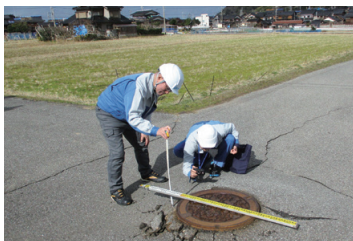
石川県輪島市における被害調査
