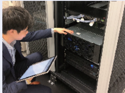
専門エンジニアによる入念なサーバーメンテナンス (大阪オフィス)
